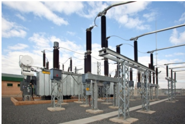
شکل ۲-۹ پست برق مورد استفاده در شبکه های انتقال و توزیع.
