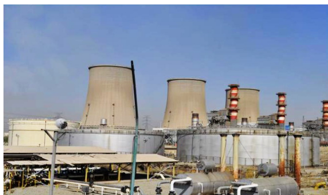
شکل ۲-۸ نیروگاه سیکل ترکیبی منتظر قائم کرج.
