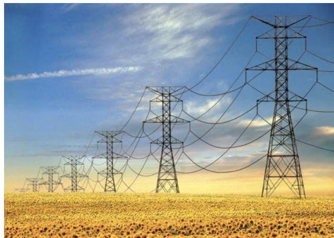
شکل ۲-۳ تصویری از یک خط انتقال با ولتاژ ۵۰۰ \text{ kV} .
